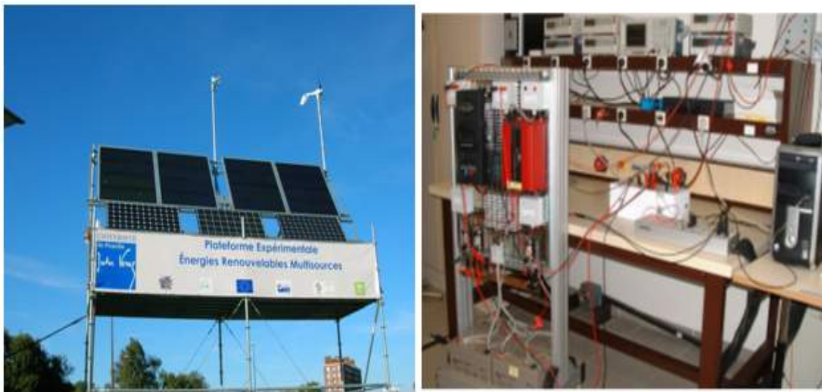
FIGURE 47 – Plateforme expérimentale du MIS
